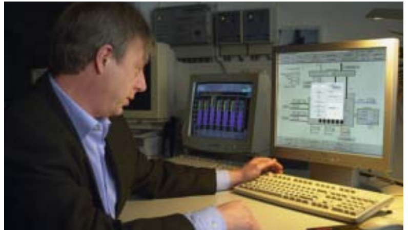
Kraftwerksleiter Jörg Schmechel kann die Prozesse vom Leitstand des Kraftwerkes aus bedienen.
