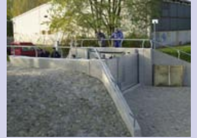
Innerhalb einer Viertelstunde geschlossen. Das neue Deichtor am Stummeldamm.
