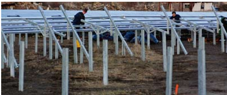
Nach Fertigstellung 2010 wird der Solarpark Calbe dann rund 7 Mio. Kilowattstunden Strom (kW/h) pro Jahr liefern.
