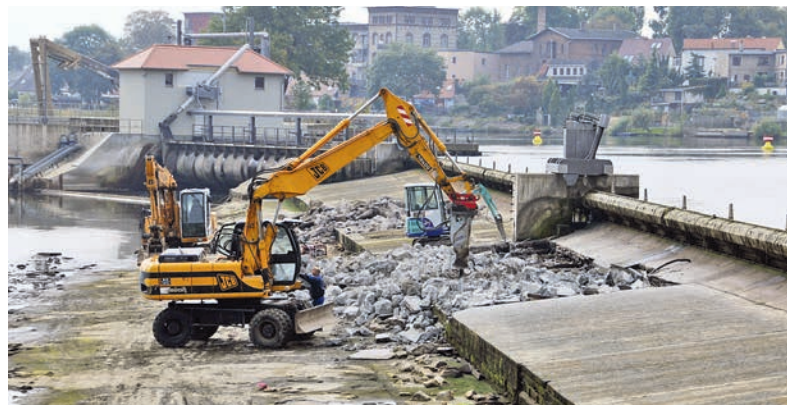
Teile des 2004 sanierten Saalewehrs mussten jetzt erneuert werden.
