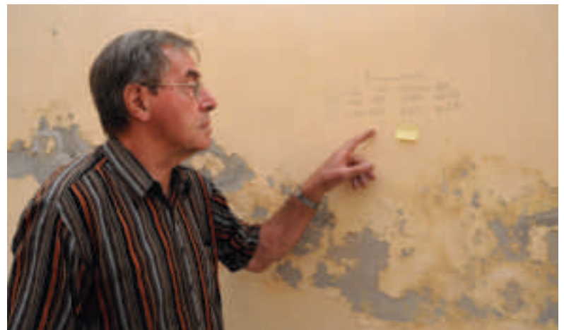
Rudi Kramer, hier auf einem Archivfoto von 2014, zeigt die Schäden in der Gedenkhalle.
