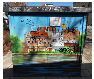
Trafostation der Avacon nach künstlerischer Gestaltung auf dem Kirchplatz beschmiert mit Graffiti
